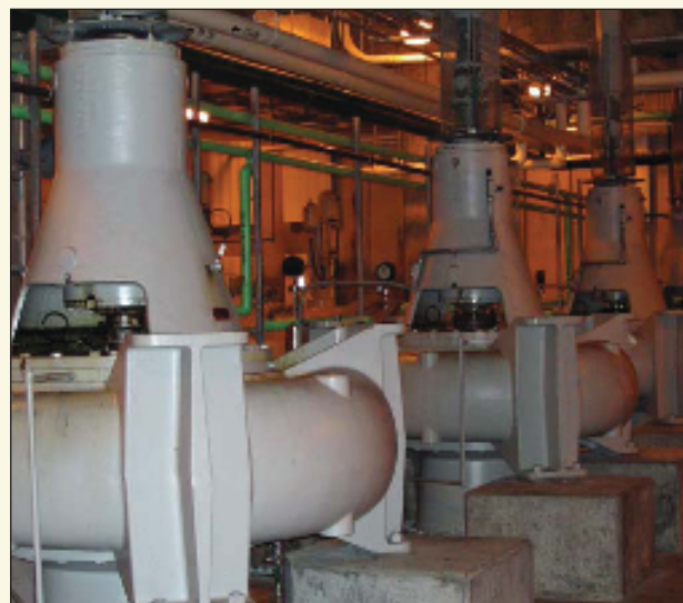
Bombas de efluentes, vedadas com selos bipartidos com diâmetro de 200 mm (8,00 polegadas), estão em funcionamento há mais de 12 anos.
